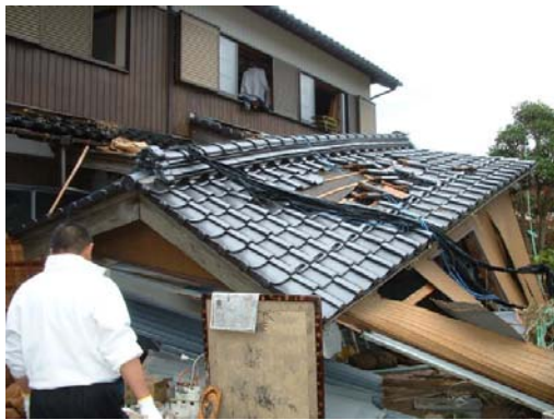
水の勢いで倒れた建物
