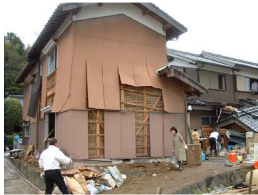
水によりトタンが剥がされる。2階まで浸水
