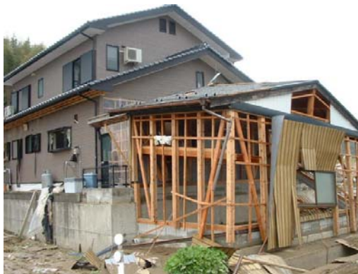
一旦浮き上り、土台から外れた車庫。
