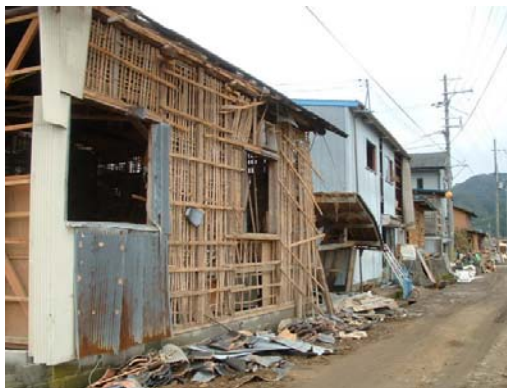
トタン板の下には土壁があったでしょうに
